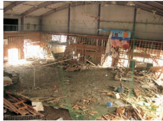
写真4-90 豊間中学校体育館の被害状況 〔4月18日 市教育委員会事務局撮影〕
