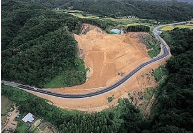
写真4-59 崩落土砂を除去し、仮設道路で開通 〔8月31日 福島県いわき建設事務所提供〕
